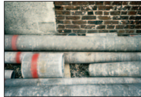
© INRS Canalisation en amiante
